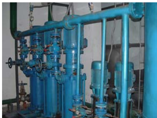
图 7 恒压供水现场外观图
