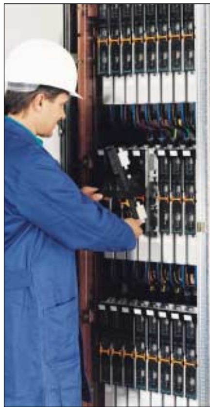
装有条型熔断器式隔离开关的电缆馈电用电柜。
