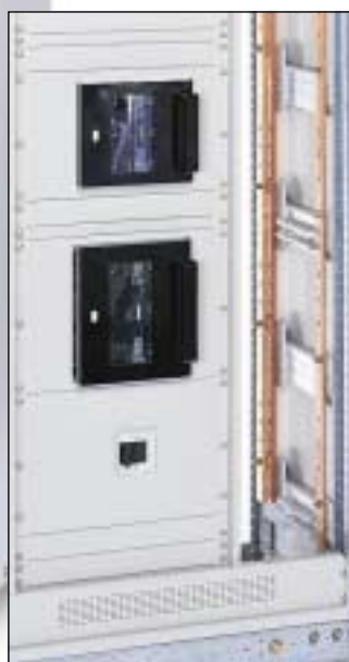
电缆馈电回路 侧面
