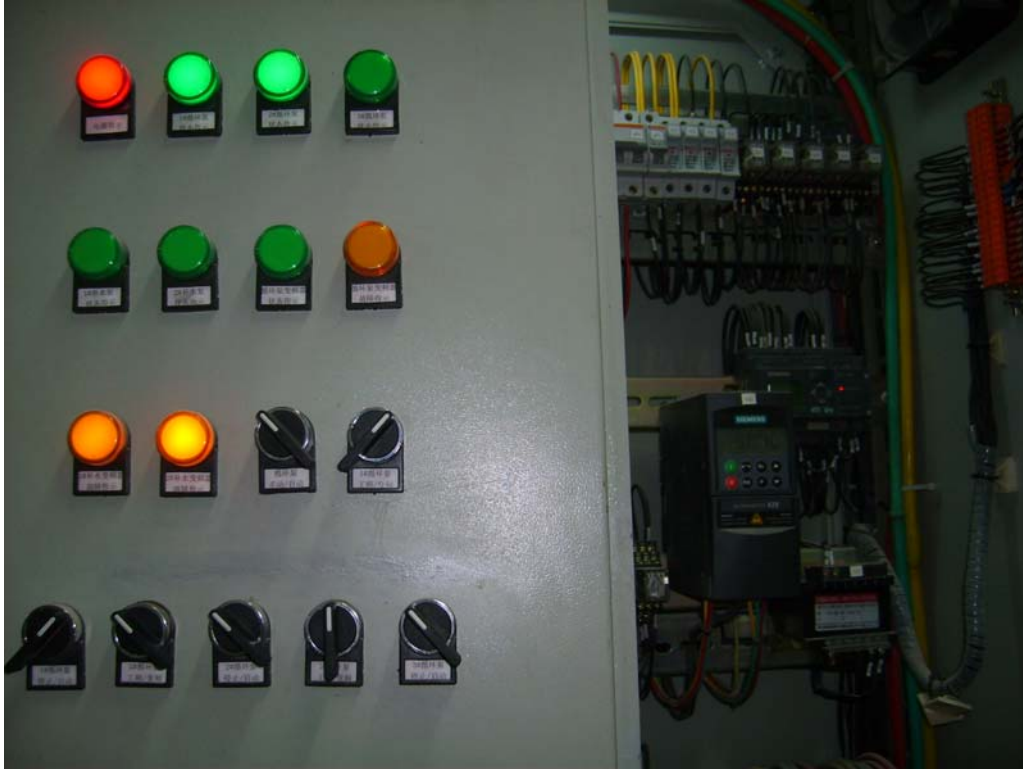
照片 1：嘉润园小区恒压供暖系统控制柜
