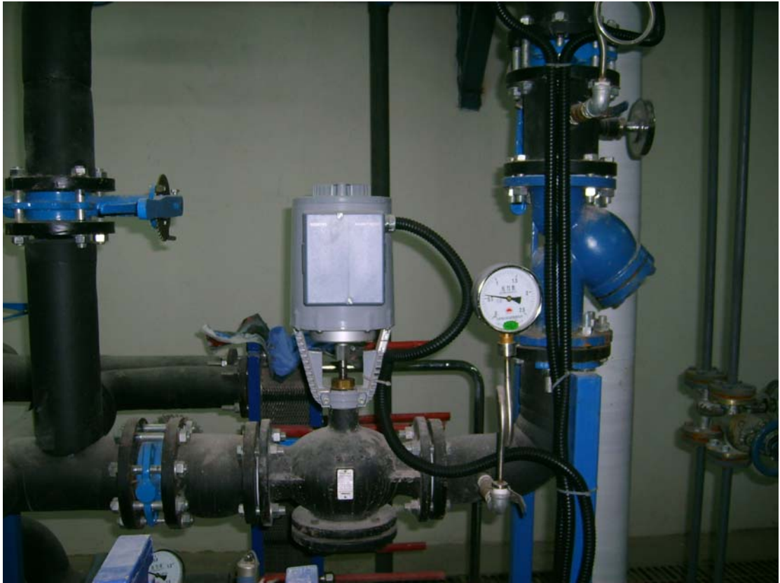
照片 5: 热交换系统中的电动流量阀
