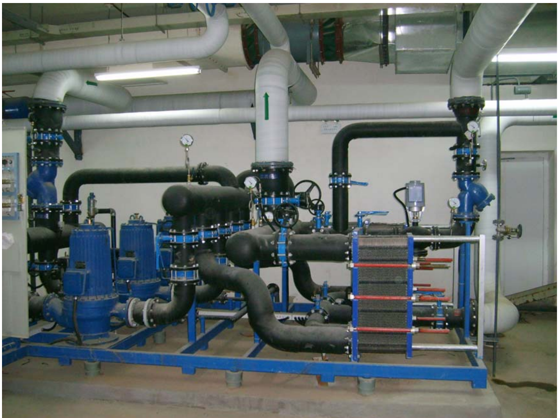
照片 6: 供暖系统中的热交换器
