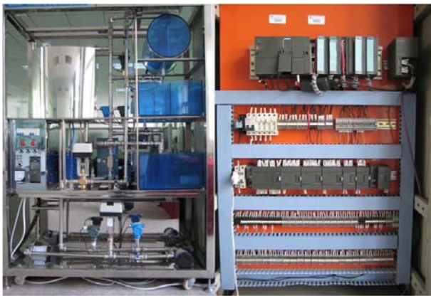
图2 PLC柜及过程控制实验装置
